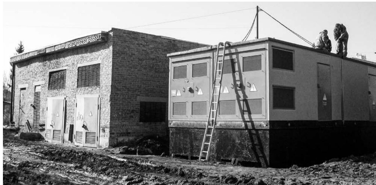
Старая и новая трансформаторные подстанции
